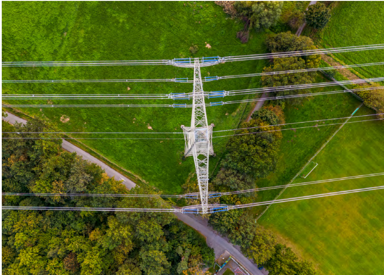
Der Netzausbau muss jetzt zügig vorangetrieben werden.
